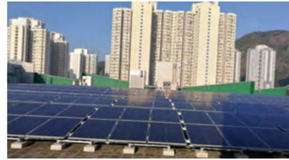
華創建設投入使用屋頂光伏綠色能源利用項目
